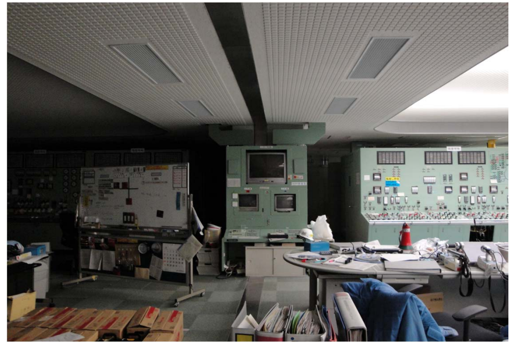
点灯した3号機中央制御室（右）、 左側は点灯する前の4号機中央制御室 [3月22日撮影]
