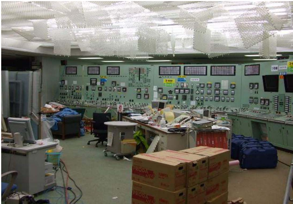
点灯した1号機中央制御室照明 (照明カバーが地震の影響で外れている) [3月24日撮影]
