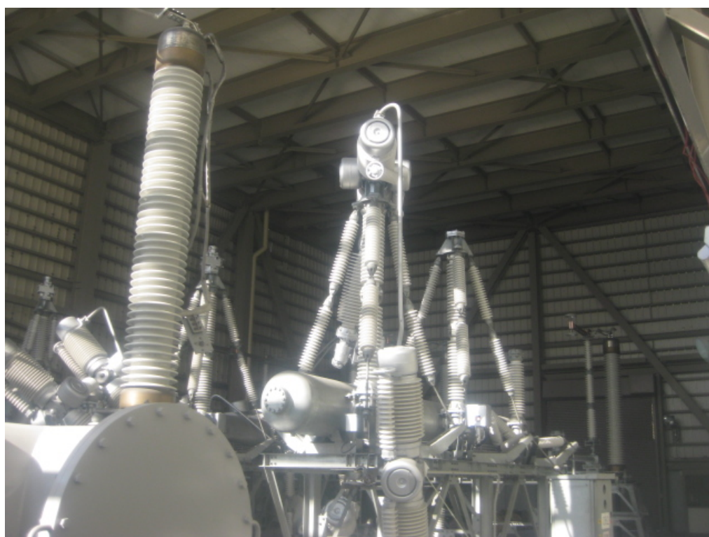
撮影：東京電力株式会社 H23.3.23
