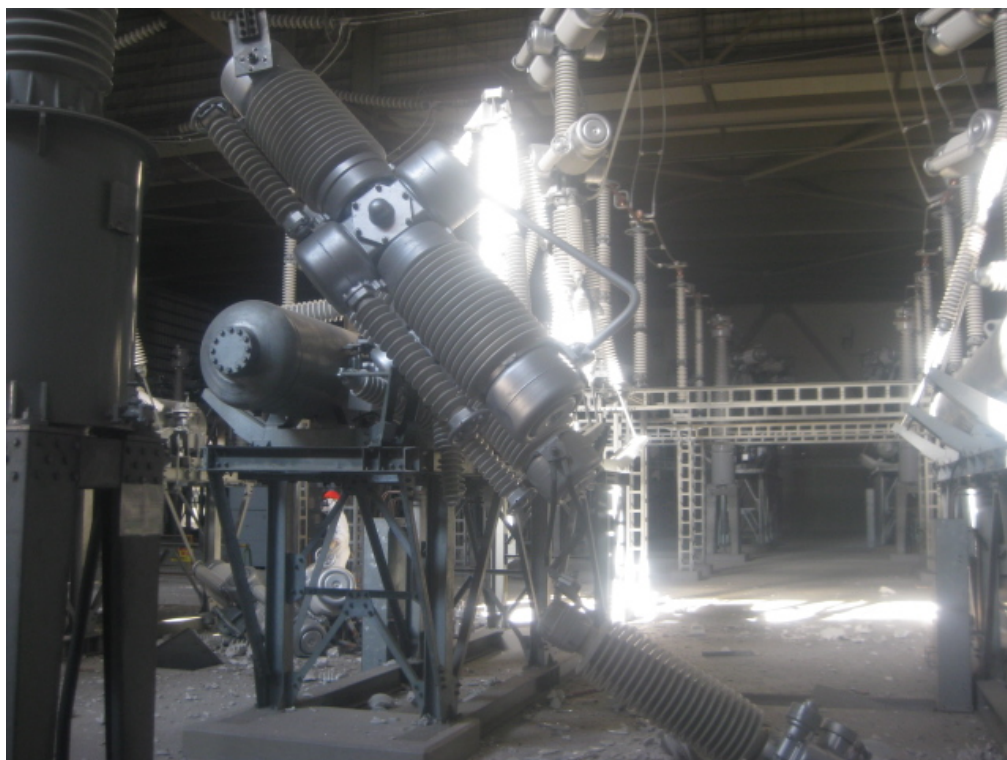
撮影：東京電力株式会社 H23.3.23
