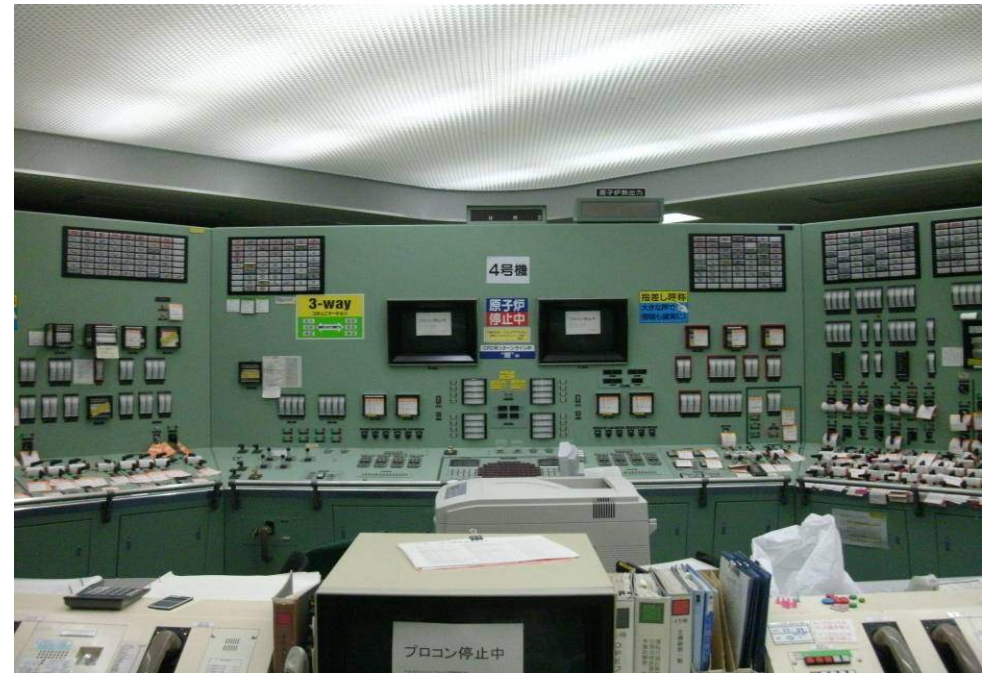
点灯した4号機中央制御室照明
