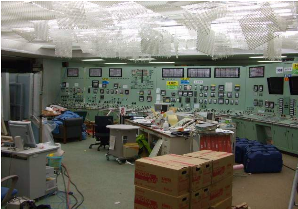
点灯した1号機中央制御室照明 (照明カバーが地震の影響で外れている)
