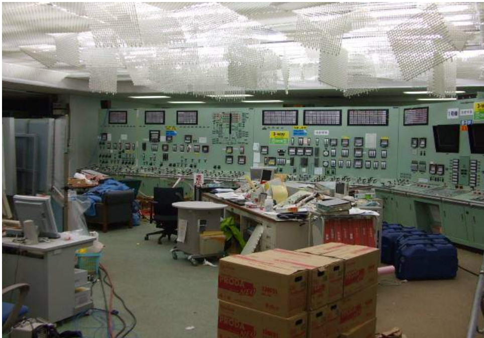
点灯した1号機中央制御室照明 (照明カバーが地震の影響で外れている)
