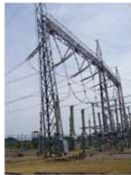
撮影：東京電力株式会社 H23.3.11
