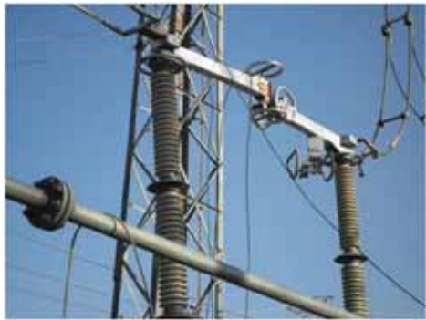
撮影：東京電力株式会社 H23.3.12
