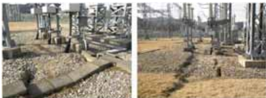
撮影：東京電力株式会社 H23.3.12
