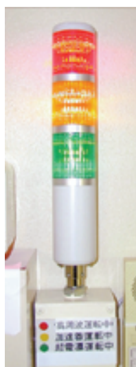
パイロットランプ三色燈 赤色点滅灯は高電圧・強磁場，青色点滅灯は高圧ガス製造施設または高周波加速空洞（KEKB区域）運転中を知らせる。
