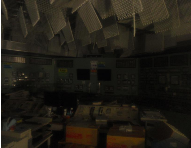
写真1 1,2号機中央制御室の状況
