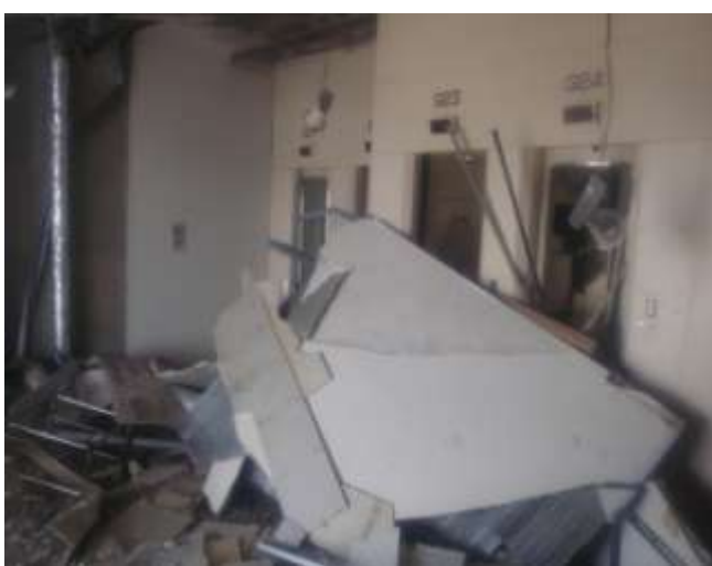
写真4 セキュリティゲート
